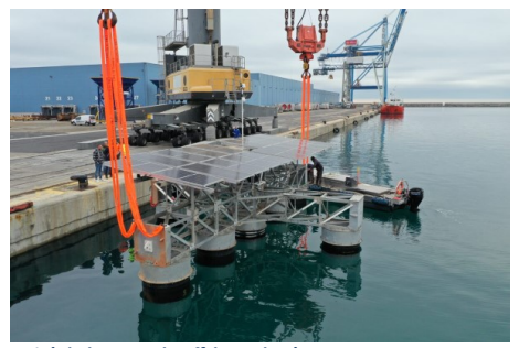
Unité de la centrale offshore de Sète
